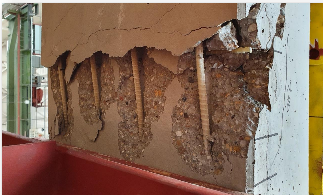
Obr. 4.13 Porušenie prvku S3 – spodná strana
