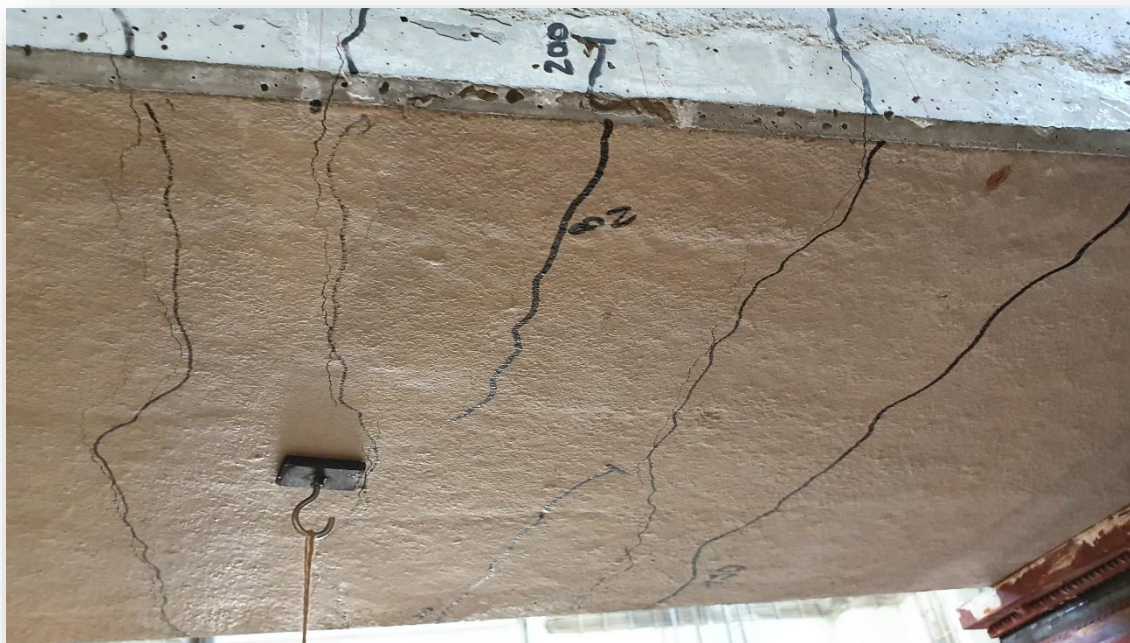
Obr. 4.4 Rozvoj trhlín S1 - spodný povrch
