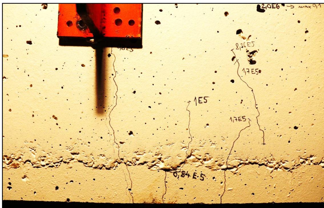
Obr. 4.21 Stav poškodenia prvku D2 po 2E6 zaťažovacích cykloch
