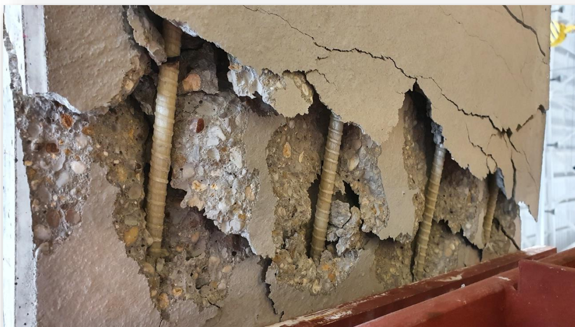
Obr. 4.9 Porušenie prvku S2 – spodný povrch
