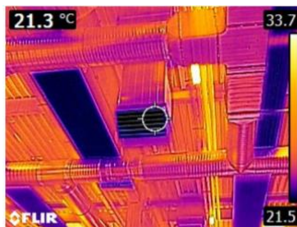
Obr. 3.2 Teplota privádzaného vzduchu na výstupe z adiabatického chladiča
