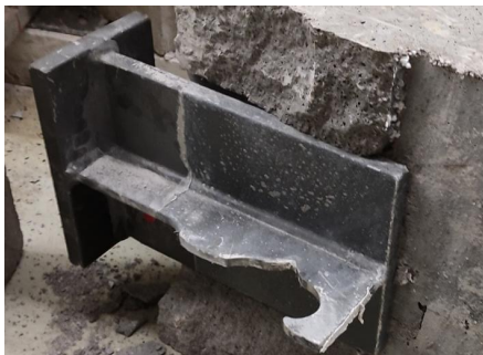
Obrázok 17: Porušenie ocelového šmykového konektora v mieste drieku
