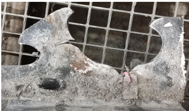
Obrázok 20: Porušenie oceleového šmykového konektora v mieste drieku
