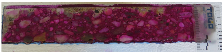
Obr. 4.3: Hĺbka karbonatizácie betónu krytého omietkou EXP 10-39 (čistá) [III].
