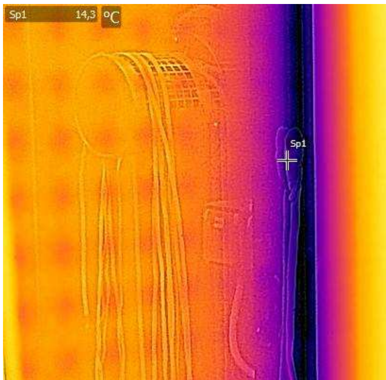
Obr. 4.13 Pohľad na styk zasklenia a rámu cez termovíziu kameru, na danom snímku sú viditeľné aj zvýšené tepelné toky kondukciou cez dištančné pilieriky
