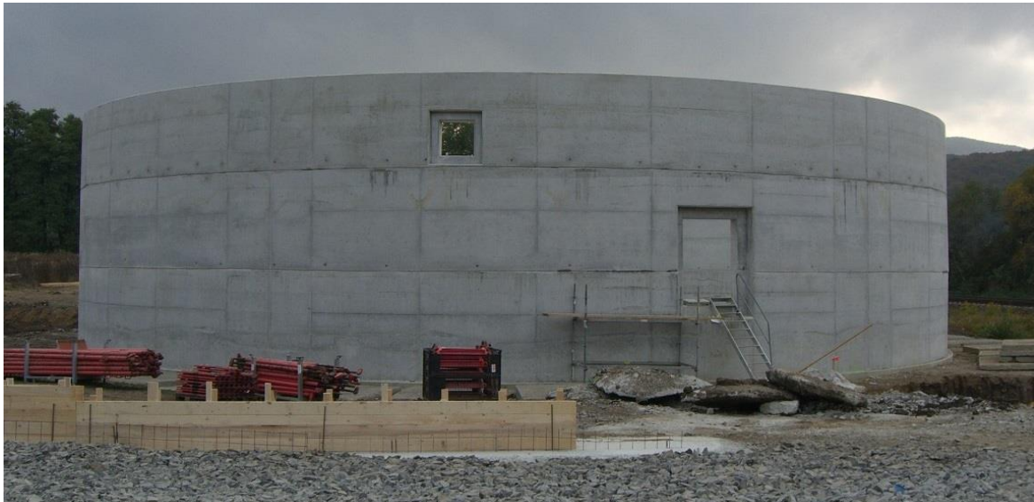
Obr. 5.2 Reálna konštrukcia valcovej nádrže
