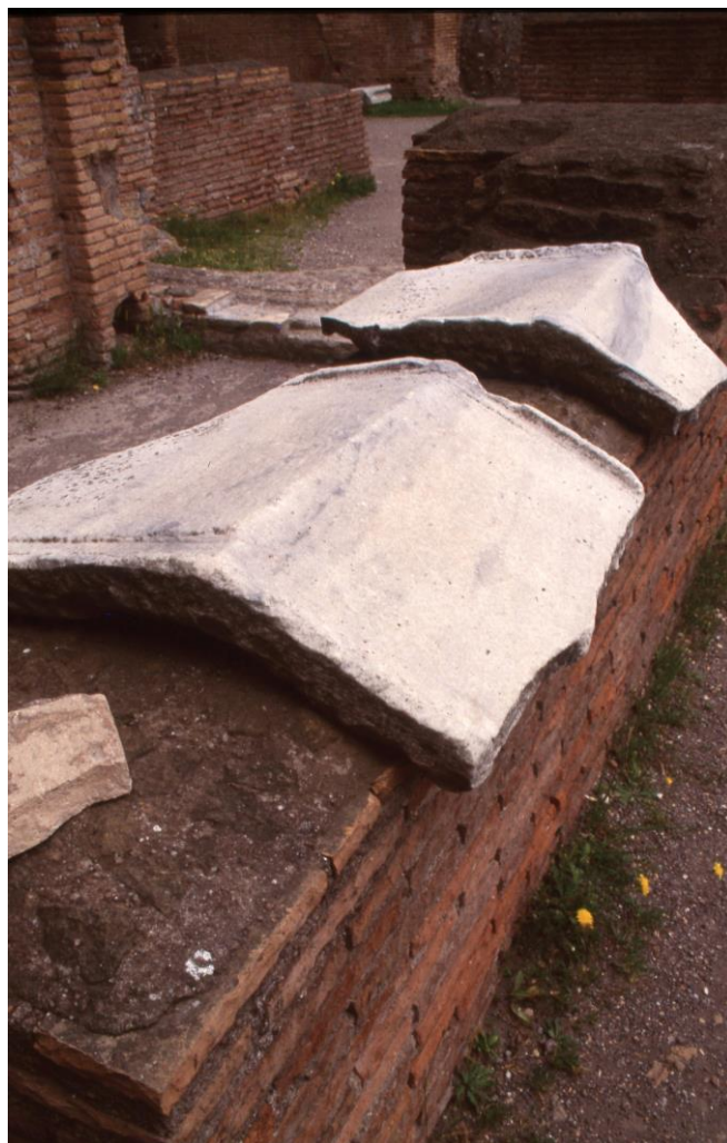
Obr. 4-2-1. Rímske mramorové strešné hrebenáče s vysokou odolnosťou voči erózii. Ako vidno sú poškodené len mechanicky.
