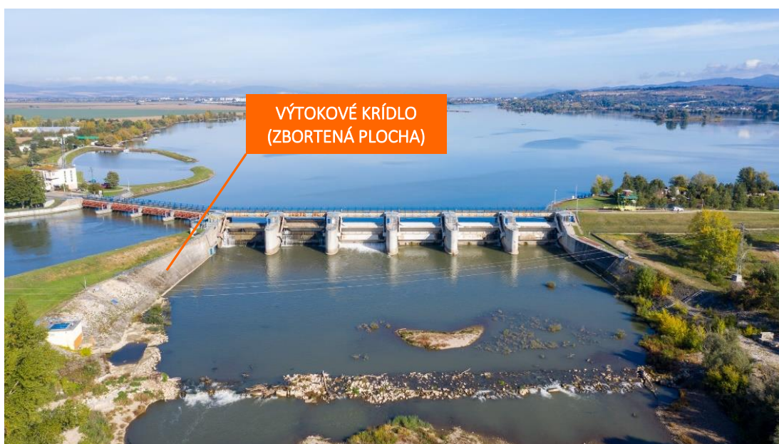
Obr. 4.24 Zbortená plocha výtokového krídla na hati Vodného diela Drahovce na Váhu (Zdroj: https://www.pic-piestany.sk )
