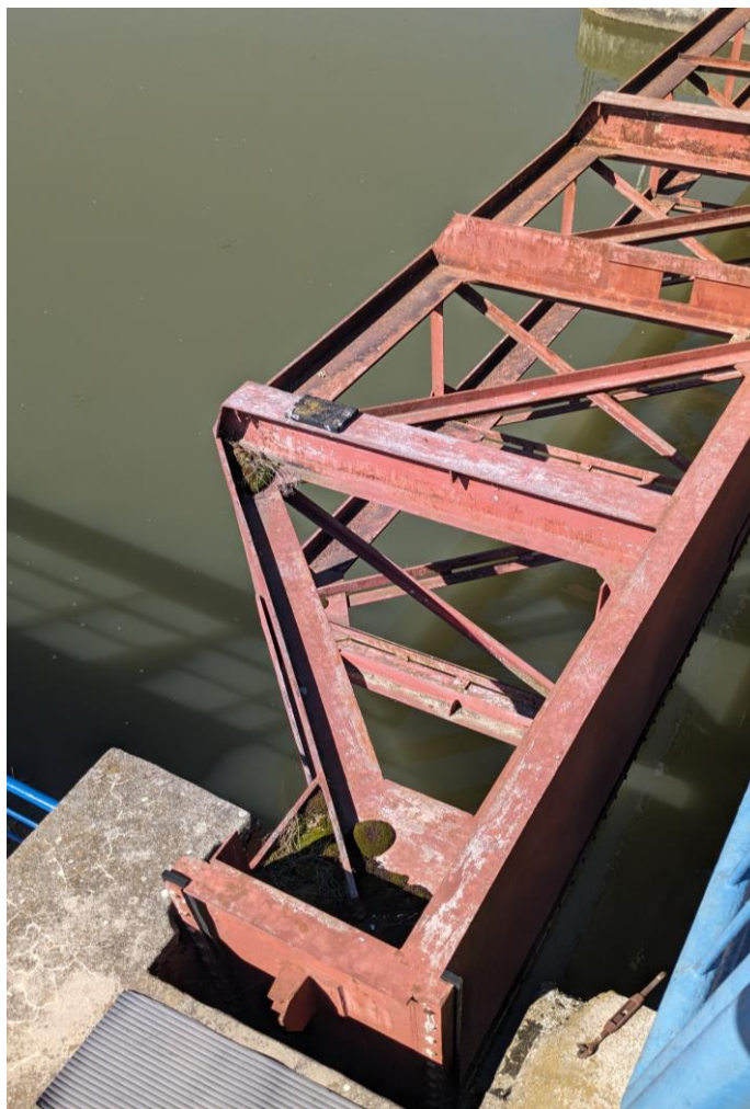
Obr. 9.6 Jedno zo štyroch ocelových hradidiel z priehradového nosníka pre provizórne hradenie haťových polí na hati Vodného diela Drahovce (Zdroj: archív autora)
