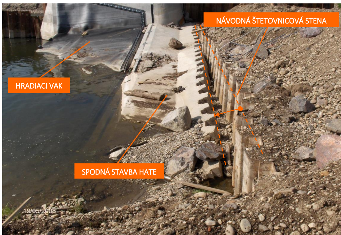
Obr. 5.30 Havária hate Šárovce na Hrone spôsobená prelomením podlažia (Zdroj: archív autora)
