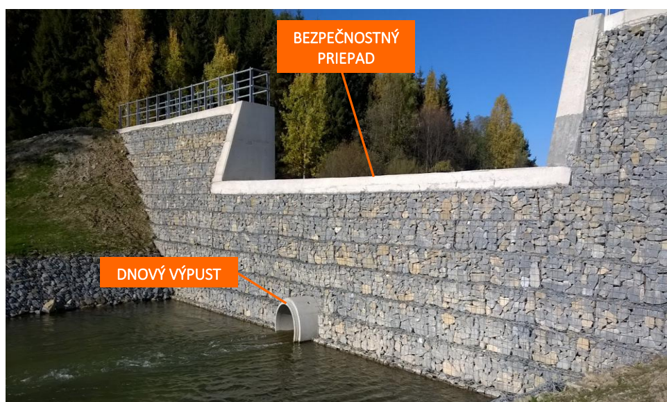
Obr. 3.5 Polder Ľubica – prepúšťanie bežného prietoku v čase mimo povodne (Zdroj: gabion-consult.sk)
