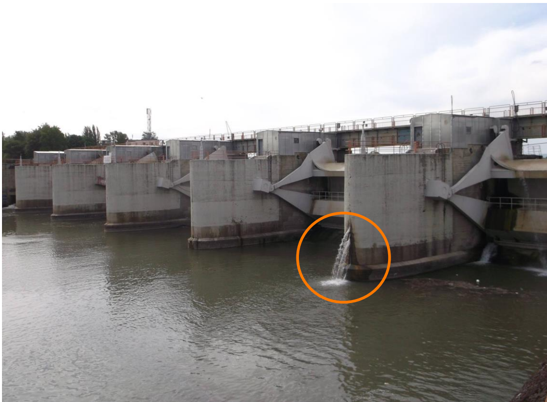
Obr. 5.72 Priesak cez pilier hate Drahovce na Váhu spôsobený poškodením gumového pásového tesnenia dilatačnej škáry (rok 2010) – (Zdroj: pnky.sk)
