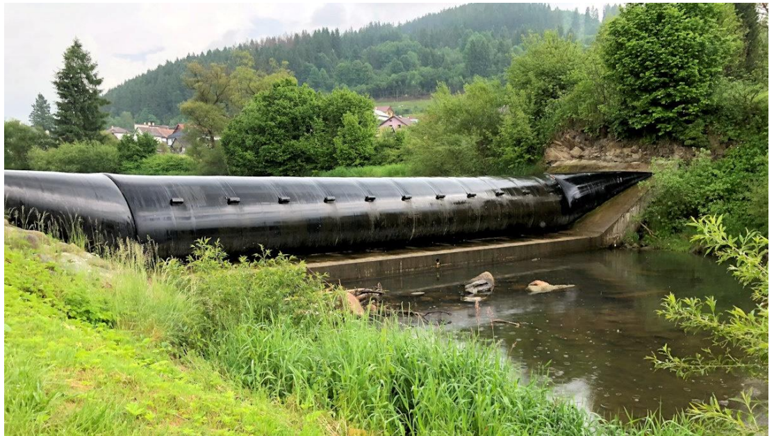
Obr. 8.98 Vakový uzáver prikotvený k spodnej stavbe a k šikmým brehovým pilierom s hradiacou výškou 3,0 m a šírkou 25,0 m – hať Filipovo na rieke Hron (Zdroj: rieky.sk, © Matej Mikluš)
