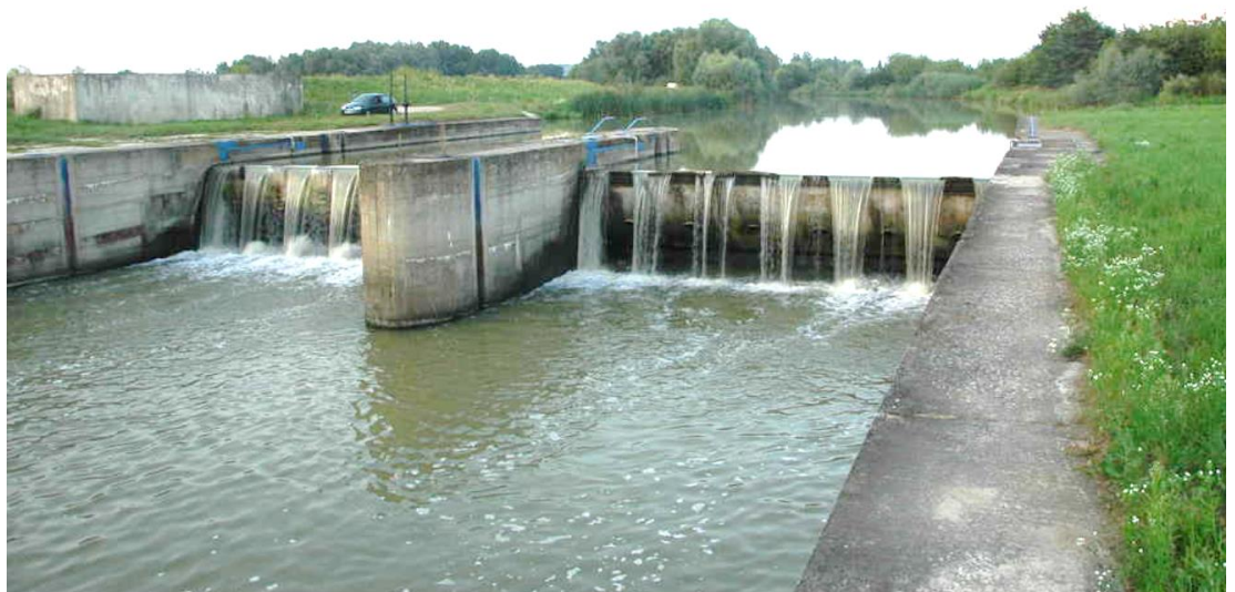
Obr. 8.63 Zavesená klapka ovládaná hydraulickým piestom umiestneným pod hladinou maximálnej prevádzkovej hladiny – hať Preseľany nad Ipľom (Zdroj: biomonitring.sk, © David Stanislav)
