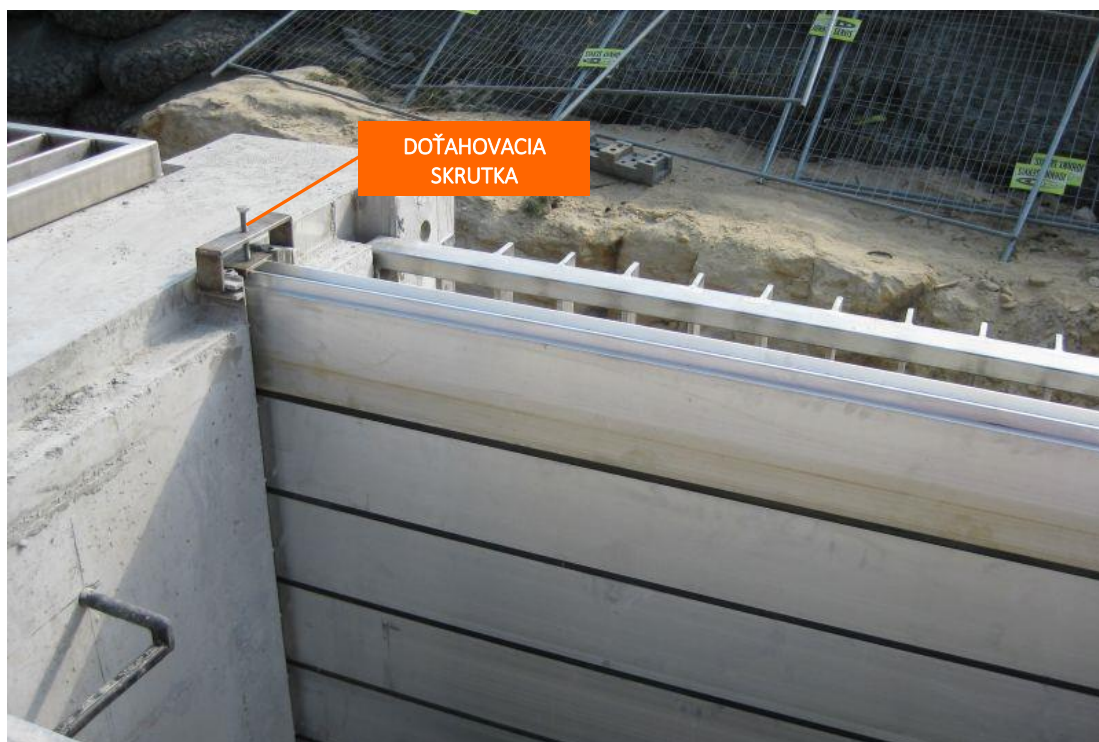
Obr. 9.3 Hliníkové hradidlové provizórne hradenie (Zdroj: mvprojekt.cz)
