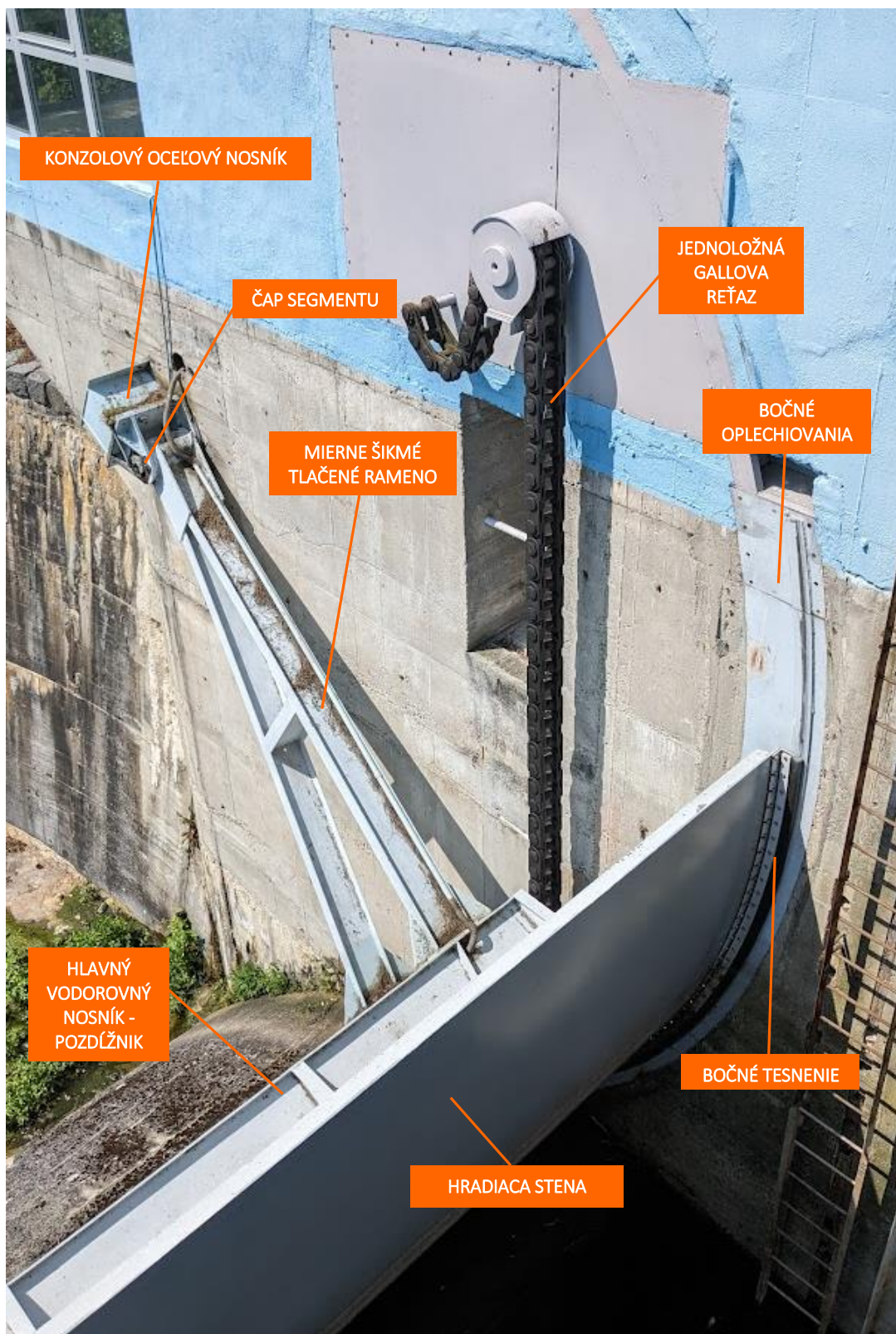
Obr. 8.65 Zdvižný segment s tlačeními ramenami – Vodné dielo Dalešice na rieke Jihlava, ČR (Zdroj: © MUDr. Tomáš Török)
