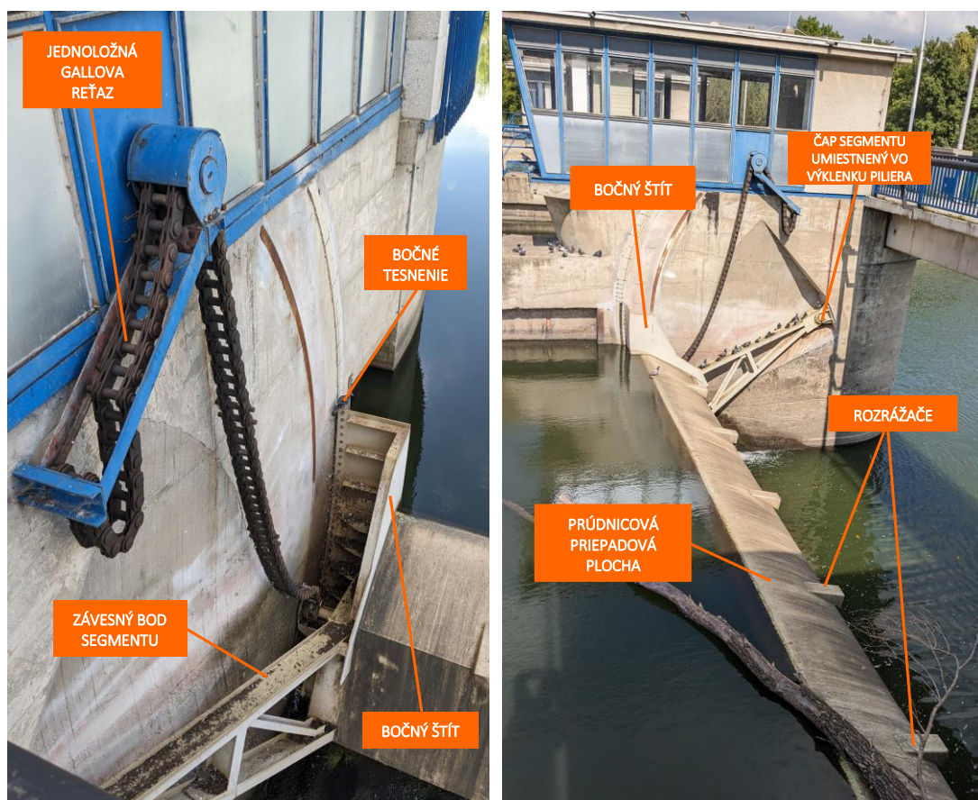
Obr. 8.77 Zdvižný segment s mierne šikmými tlačeními ramenami a s hornou hranou konštrukcie upravenou pre prepúšťanie vody prepadom na hať MVE Bulhary na rieke Dyje, ČR (Zdroj: archív autora)
