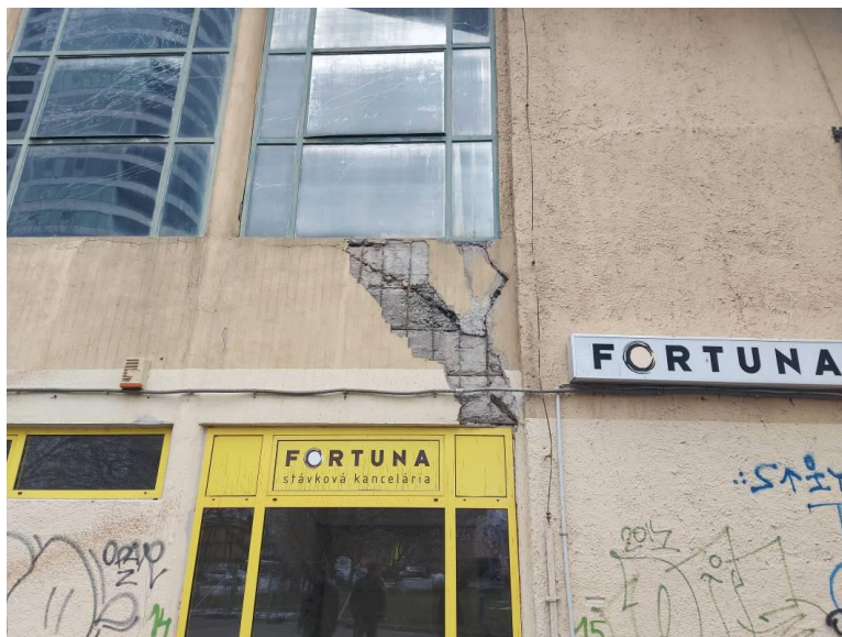
Obr. č.5 – Poškodenie vysokého obvodového nosníka šmykovými trhlinami
