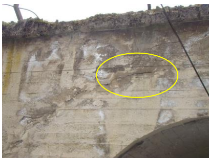
a) Trhlina v čele klenby (MO č. 209)
