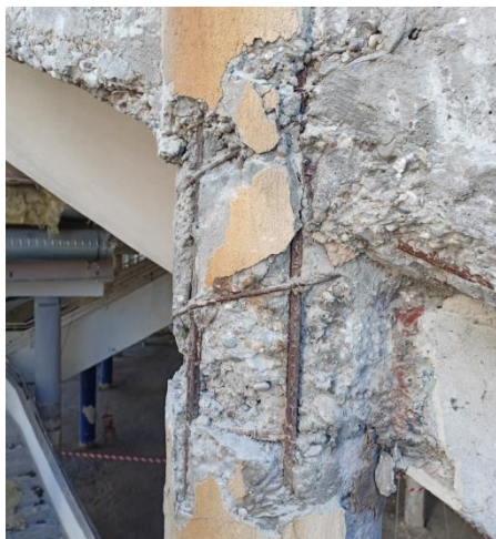
Obr.č.2 Degradovaný betónový povrch
