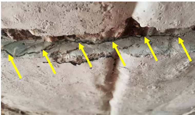
Obrázok 1.3: Delaminácia krycej vrstvy objavená v drážke.
