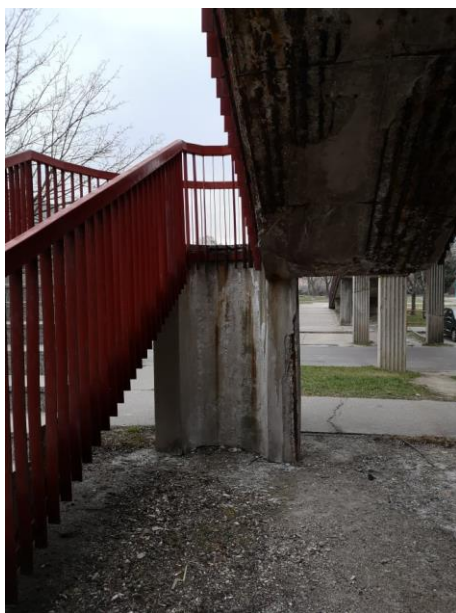
Obr. 3 Poškodenie podperného stĺpa a spodnej plochy schodiska
