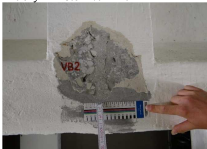
Obr. 2.5 Obrus v místě kontaktní spáry a kontrola trhlin
