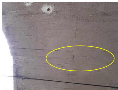
b) Trhlina vo vrchole klenby (MO č. 209)
