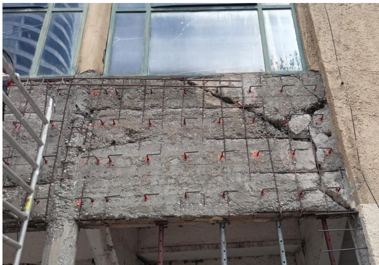
Obr. č.7 Poškodený obvodový nosník v mieste budúcej sanácie
