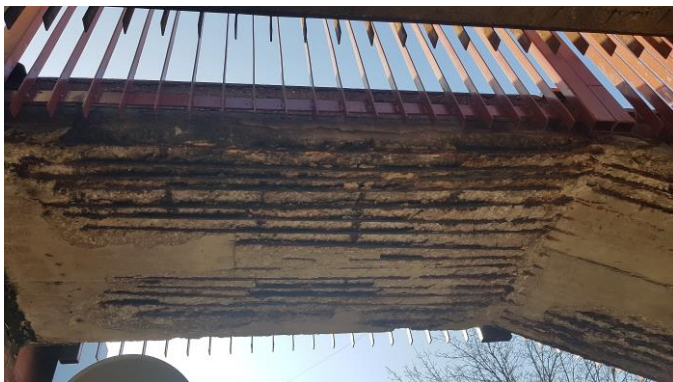
Obr. 2 Poškodenie spodnej strany schodiska s korodujúcou výstužou
