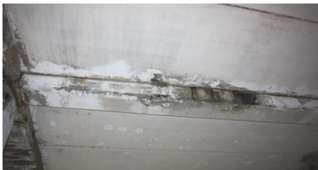
Obr. 3 Vplyv zatekania na konštrukciu
