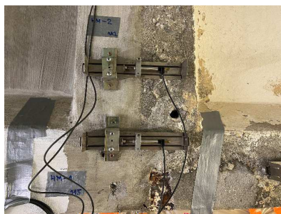
Obr. 4.4 HM u spodního povrchu přes spáru
