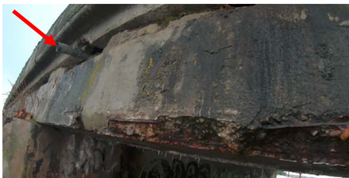
Obrázok 1.2: Problematicky riešené odvodnenie mosta.
