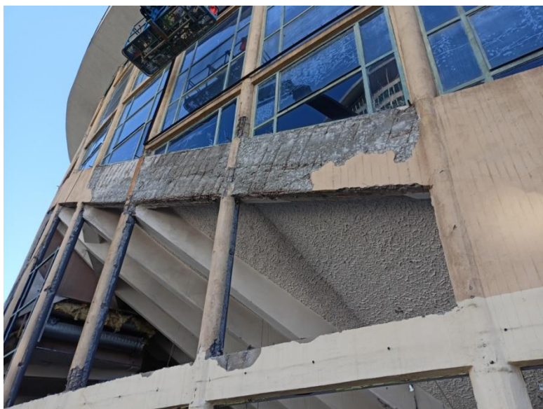
Obr. č.6 Obnažená výstuž na obvodovom nosníku
