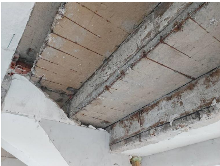
Obr. č.9 Degradovaný povrch a nulové krytie výstuže stupňovitých dosiek tribún
