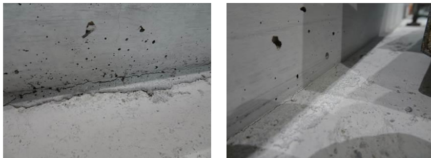
Obr. 3 Trhlina vznikajúca v rozhraní betón-betón
