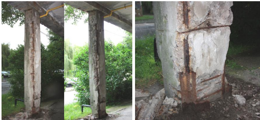
Obr. 7 Delaminácia krycej vrstvy výstuže stĺpa (vľavo) a korodujúci zvar na kotevné uholníky (vpravo)
