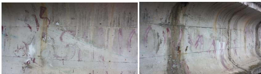
Obrázok 3 Trhliny kopírujúce káblové kanáliky
