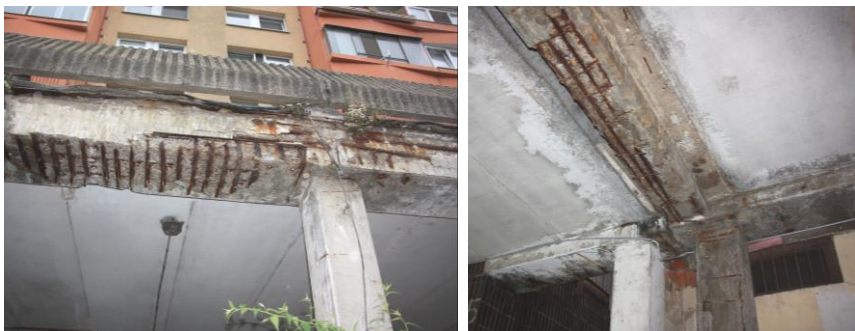
Obr. 6 Celoplošná delaminácia krycej vrstvy prievlakov a nosníkov
