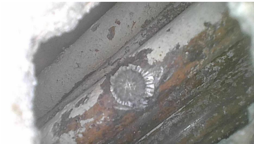
Obr.6: Kontrola injektovania káblových kanálikov – nevyplnené káblové kanáliky, povrchová korózia predpínacej výstuže
