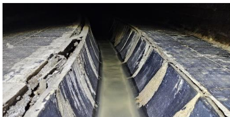
Obr. 2 Poruchy kynety a chodníčků
