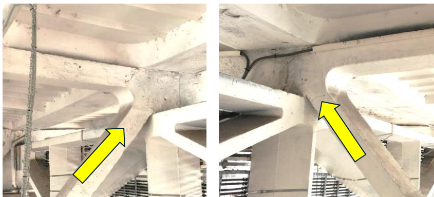
Obr.4: Trhlina v prvej diagonále priehradového väzníka
