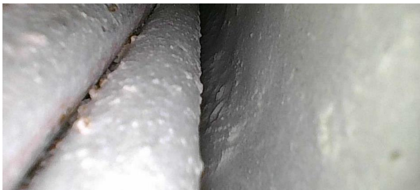
Obr.5: Kontrola injektovania káblových kanálikov – nevyplnené káblové kanáliky, povrch predpínacej výstuže chránený zvyškami cementového mlieka
