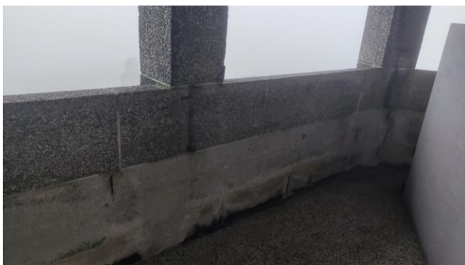
Obr. 4 Poškodenie zábradlia vyhliadky
