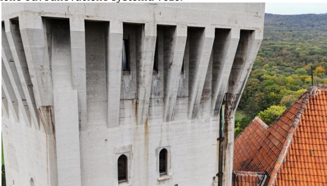
Obr. 3 Poruchy v oblasti rebier
