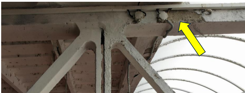
Obr.9: Odpadávanie betónu od deformácie strešného panela
