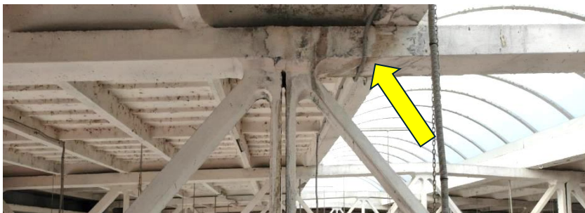
Obr.8: Zatekanie cez strašný plášť, degradácia povrchu strešných väzníkov
