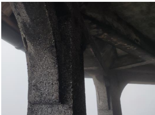
Obr. 5 Poškodenie stĺpikov a vzpier vyhliadky
