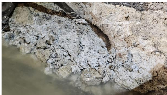
Obr. 3 Zdegradovaný podkladní beton
