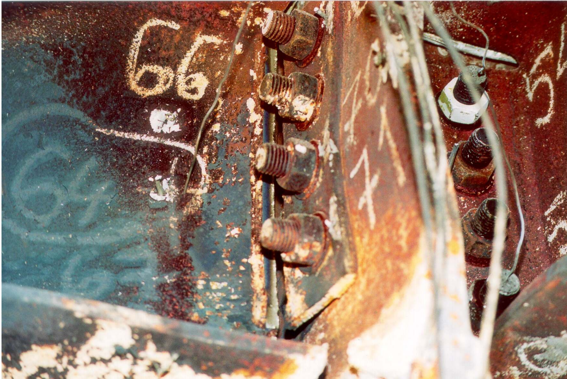
Obr. 8 Porušenie styčníka prasknutím polovice čelnej dosky pozdĺž zvaru
