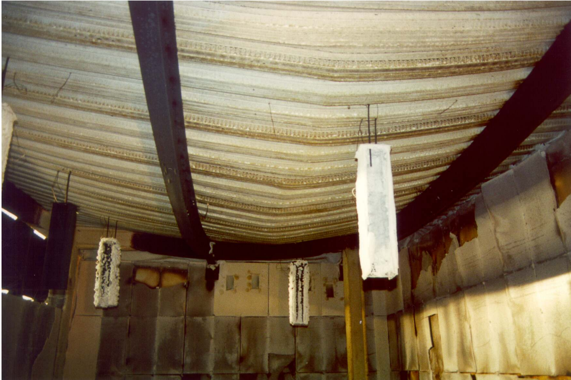
Obr. 7 Deformácia stropnej konštrukcie po požiari
