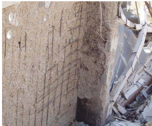
Obr. 8 Obnažená výstuž betónovej steny a betónového stĺpa
