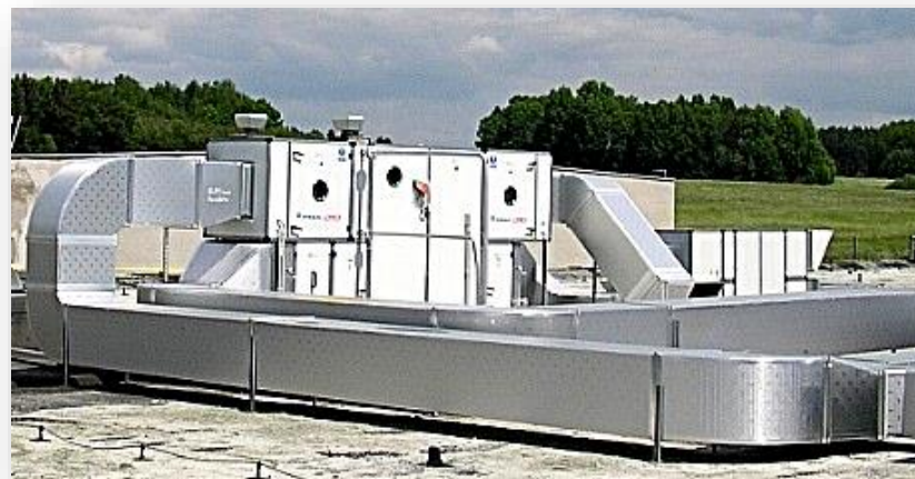
CENTRÁLNA VZT-JEDNOTKA (umiestnená na streche)
