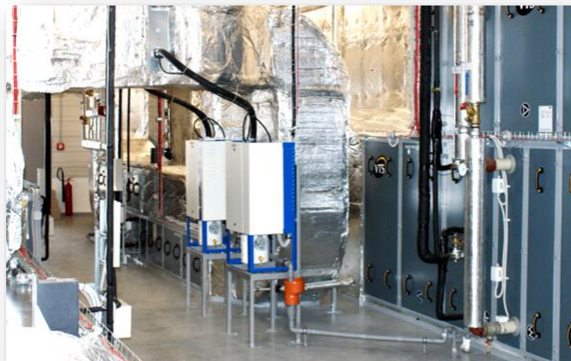
CENTRÁLNA VZT-JEDNOTKA (umiestnená v strojovni VZT)
