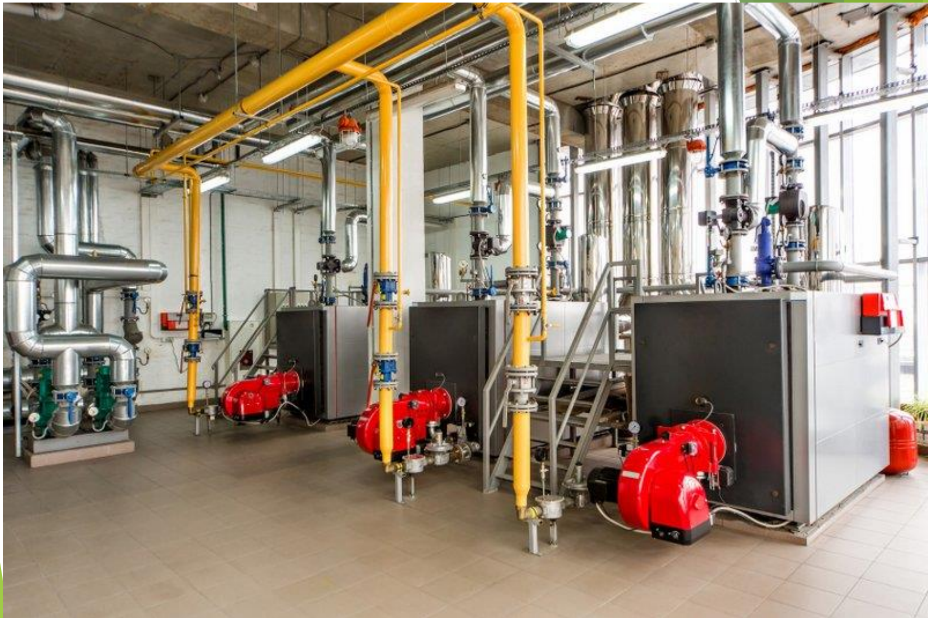
Kotolňa so stacionárnymi skriňovými kotlami opatrené tlakovými horákmi
