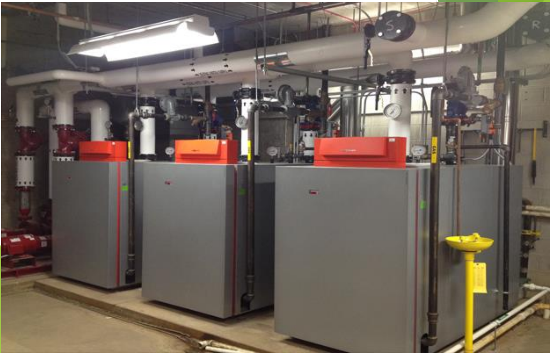
Kaskáda stacionárnych kotlov
